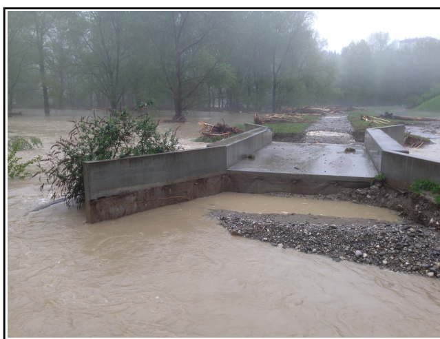
Cliché n°1 – Déconnexion d'un ouvrage d'art par la crue du Fier en mai 2015 (C. Lépinard - C2A)
